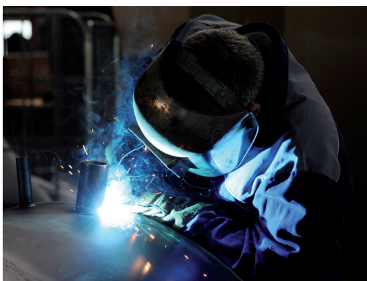
Sonderspeicher in deutscher Handarbeit, hier beim anschweißen einer Muffe
